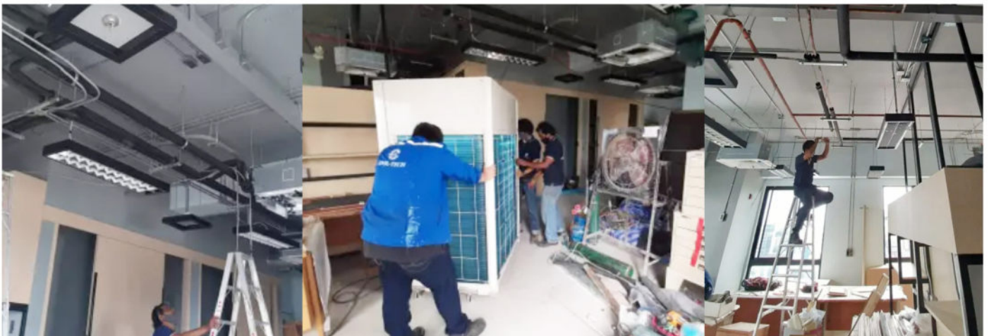
ติดตั้งเครื่องปรับอากาศแบบรวมศูนย์ (VRV, VRF) บริษัท แพลนนิ่ง แอนด์ รีเสิร์ช คอนซัลแทนด์ จำกัด | กรุงเทพมหานคร
